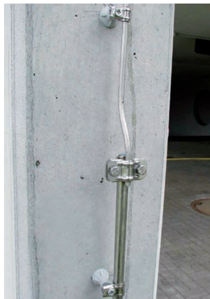
Vedenie zvodu AlMgSi so skúšobnou svorkou, ktoré pokračuje do zeme záväzovou tyčou. Záväzová tyč nahrádza zastarané ochranné uholníky.
